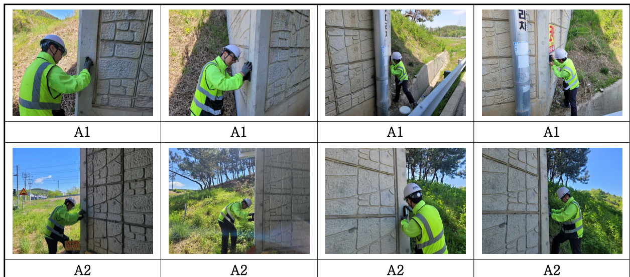
【사진 2.3.10】 교대 기울음 측정 현황
